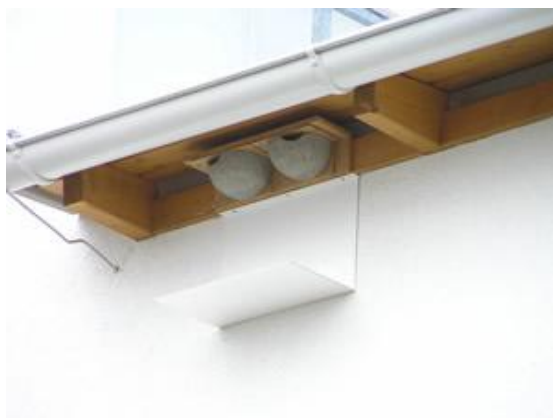
Foto 4: Fassadenschutz unter Mehlschwalben-Nestern (© Michael Stocker)
