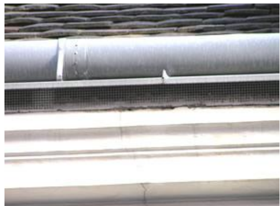
Foto 37: Das Insektengitter unter der Dachrinne verschließt ideale Mauersegler - Nistmöglichkeiten. (© Michael Stocker)
